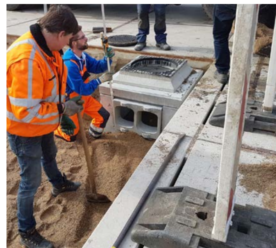
Een Bufferblock vangt tijdelijk overtollig hemelwater op.
